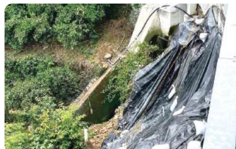
大雨で破損した南予用水の灌水及び防除施設。経年劣化が進む農業施設の機能保全は大きな課題です！
