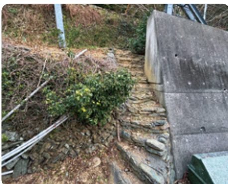
防護擁壁の整備が途中で終わり、古い石垣が剥き出しの斜面。土砂災害危険区域の整備を進めます!
