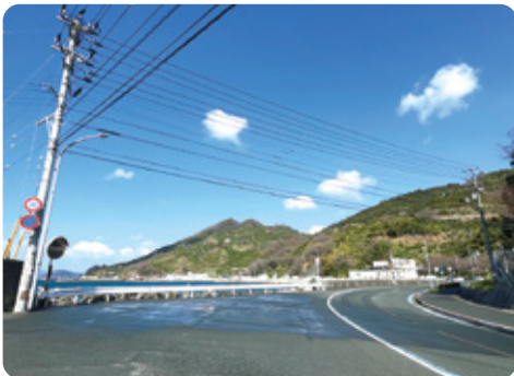
消波ブロックが破損し波が打ち上げた向灘の県道。ブロック改修を要望し、設計が始まりました。
