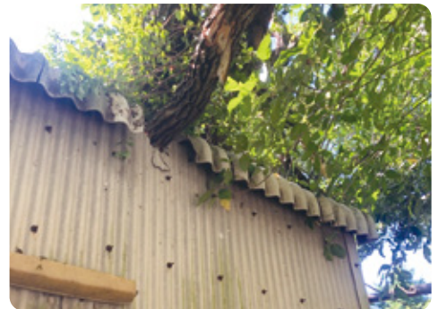
8月の日向灘地震により破損した八幡浜市内の混合水槽施設。県に早急な改修を要請しました。
