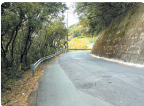
地域住民の依頼を受け地盤沈下により傾いた県道を視察。事故や災害の未然防止に注力します!
